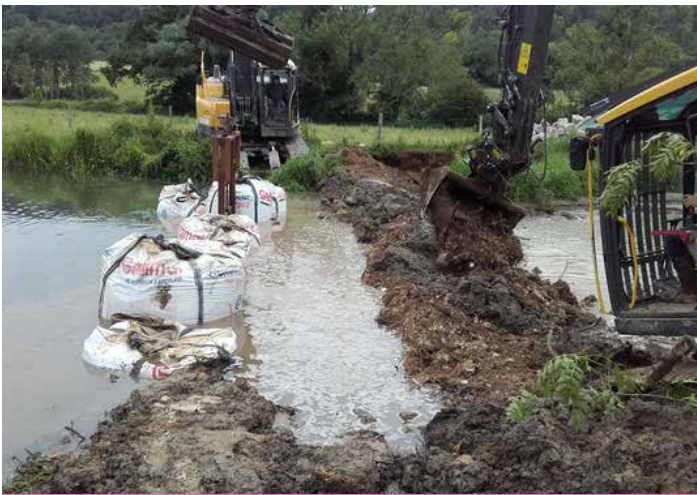
Mise en place du batardeau pour mise à sec du tronçon à reprofiler
